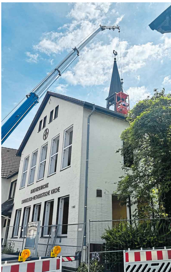
Mit zwei Kränen wurde der Kirchturm aus dem Gebäude der Kreuzkirche an der Schildescher Straße gehoben. Foto: MarcanT
